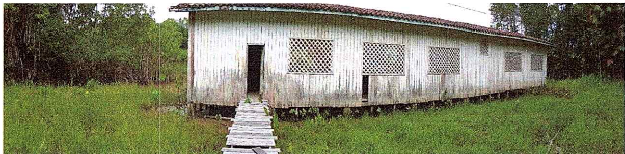
Figura 13 – Fachada Posterior deteriorada (Fonte SEMED)
