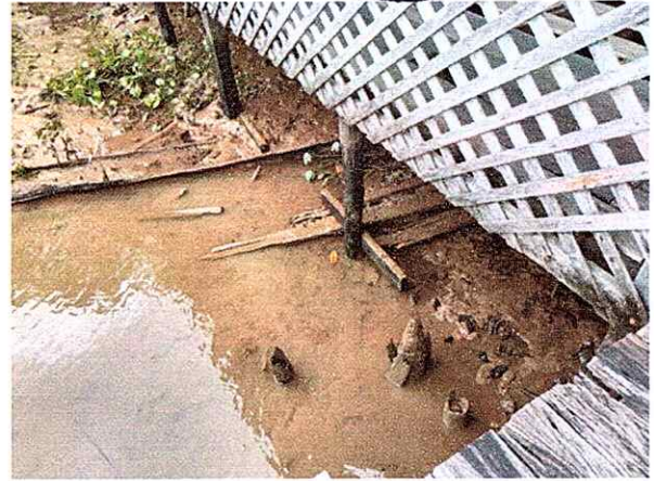
Figura 4 – Deterioração das estacas do prédio (Fonte SEMED)
