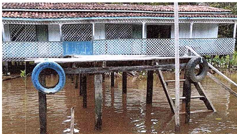
Figura 2 - Deterioração da ponte (Fonte SEMED)
