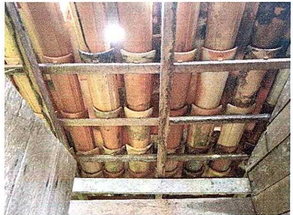
Figura 17 – Deterioração do telhado do banheiro (Fonte SEMED)
