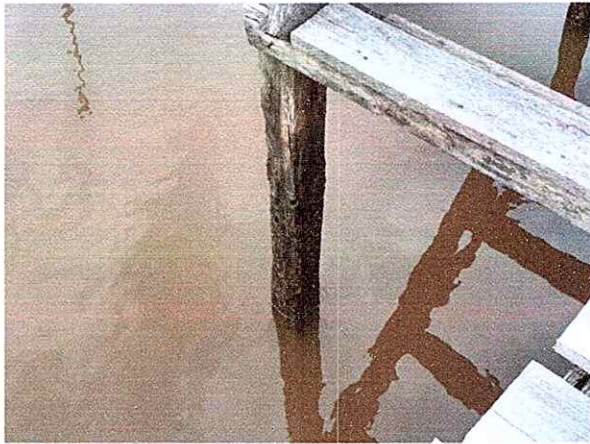
Figura 3 – Deterioração das estacas da ponte (Fonte SEMED)
