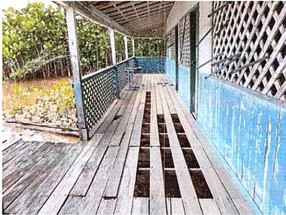
Figura 5 – Deterioração do piso do hall (Fonte SEMED)
