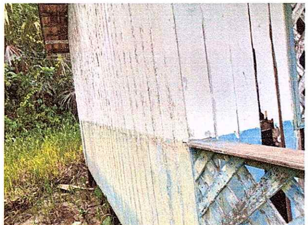
Figura 8 – Deterioração da pintura lateral (Fonte SEMED)
