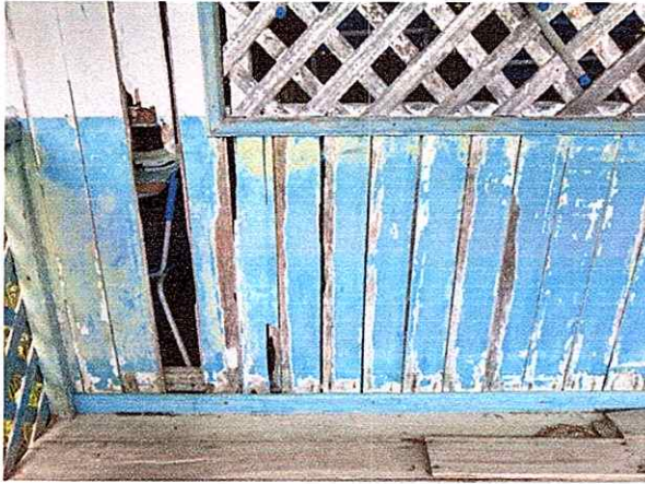
Figura 6 – Deterioração da parede frontal (Fonte SEMED)
