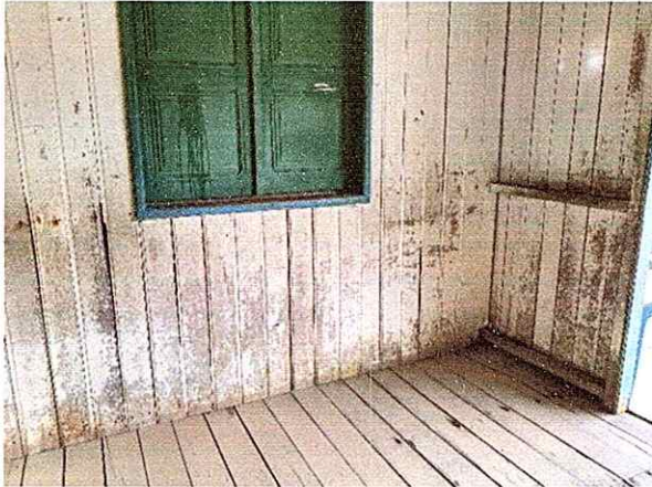
Figura 14 – Deterioração da pintura interna (Fonte SEMED)
