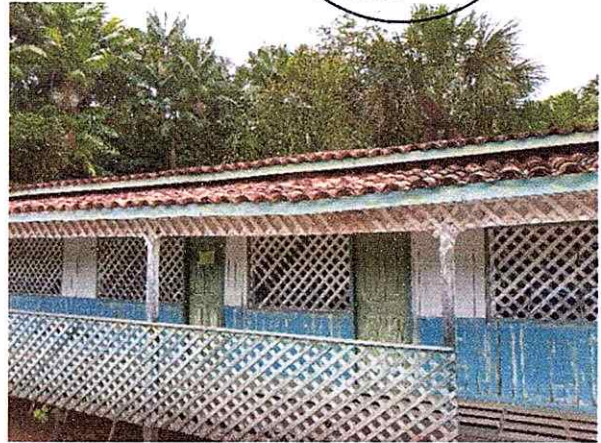
Figura 7 – Desalinhamento do telhado (Fonte SEMED)
