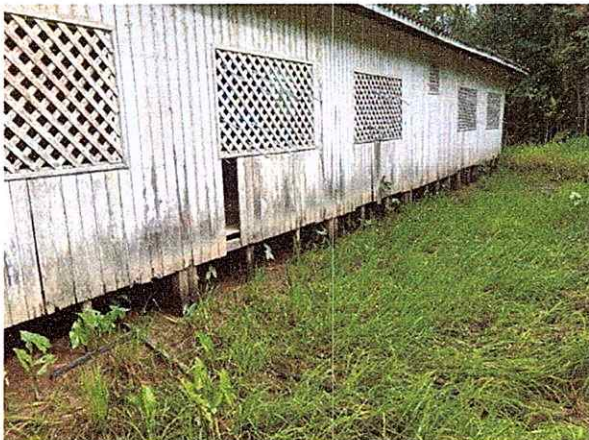
Figura 4 – Deterioração das paredes (Fonte SEMED)
