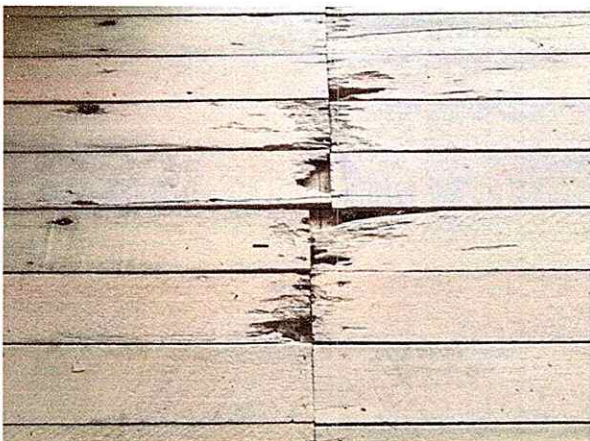
Figura 7 – Deterioração do piso da cozinha (Fonte SEMED)
