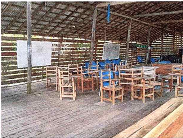
Figura 7 - Madeiramento do telhado deteriorado (Fonte SEMED)
