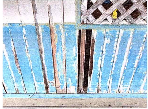
Figura 6 – Deterioração das paredes (Fonte SEMED)
